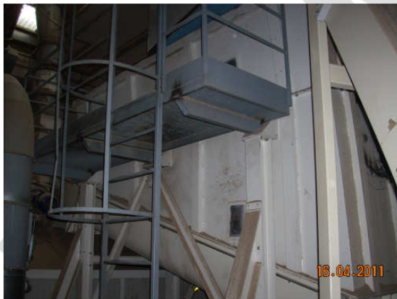
Tramoggia deposito prodotto essiccato
