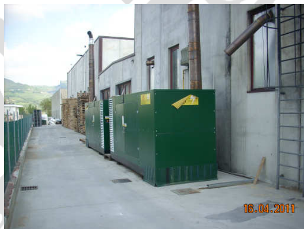
Elettrogeneratori per funzionamento impianto
